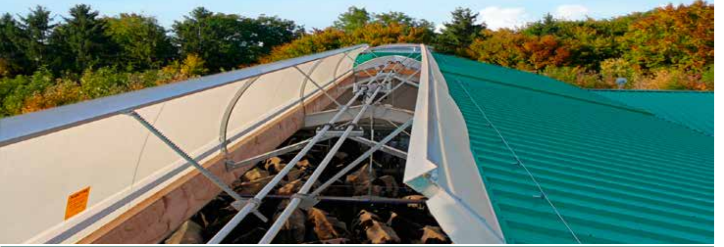
ıřık ve havalandırma sistemi
